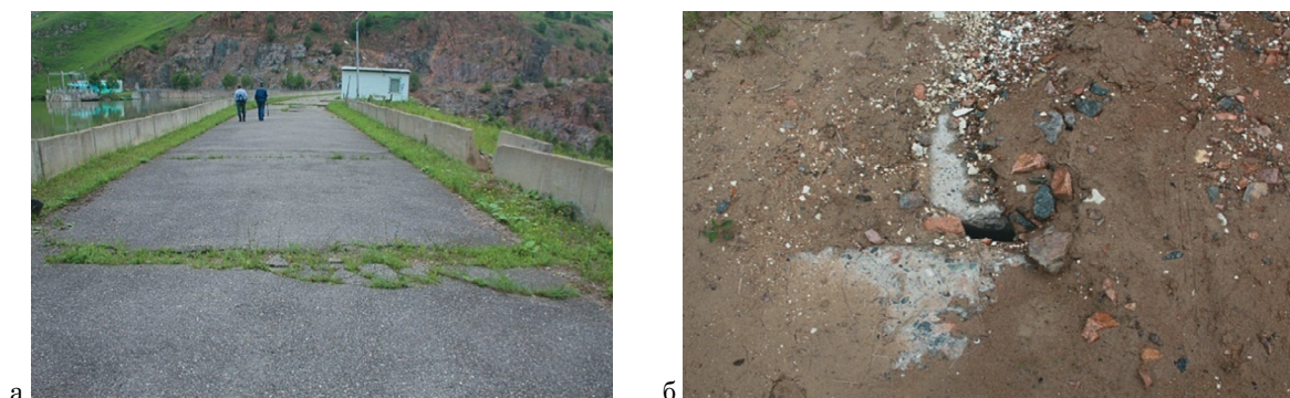
Рис. 6. Дефекты каменно-земляной плотины:
