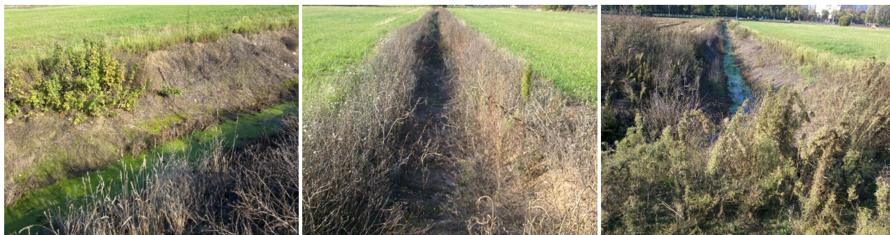
Рис. 2. Состояние каналов мелиоративной осушительной сети до очистки
