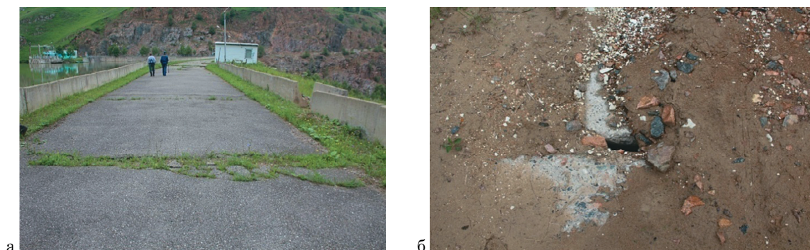
Рис. 6. Дефекты каменно-земляной плотины:
