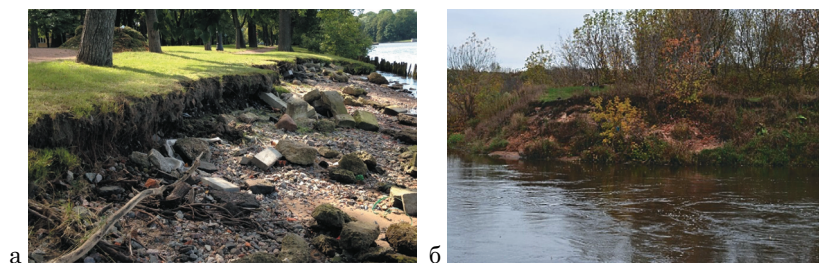
Рис. 2. Эрозия берегов водотоков:
