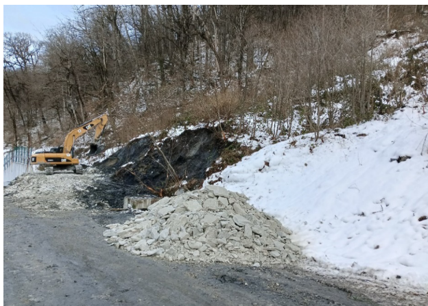
Рис. 2. Первоначальное состояние склона
