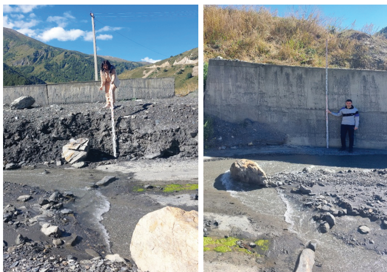
Рис. 3. Состояние селепропускных лотков Fig. 3. Condition of mudflow gutters
