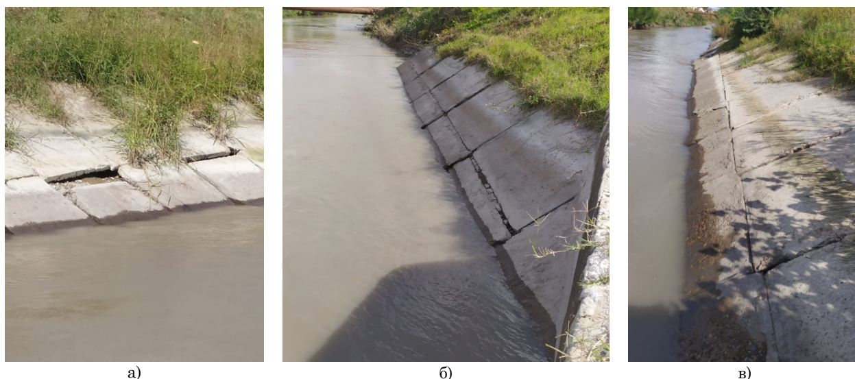
Рис. 1. Дефекты покрытий оросительных каналов:
