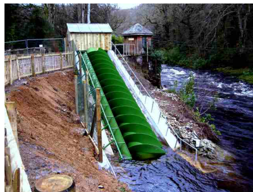
Рис. 3. Пример реализации малой энергетической установки с использованием турбины Архимеда
